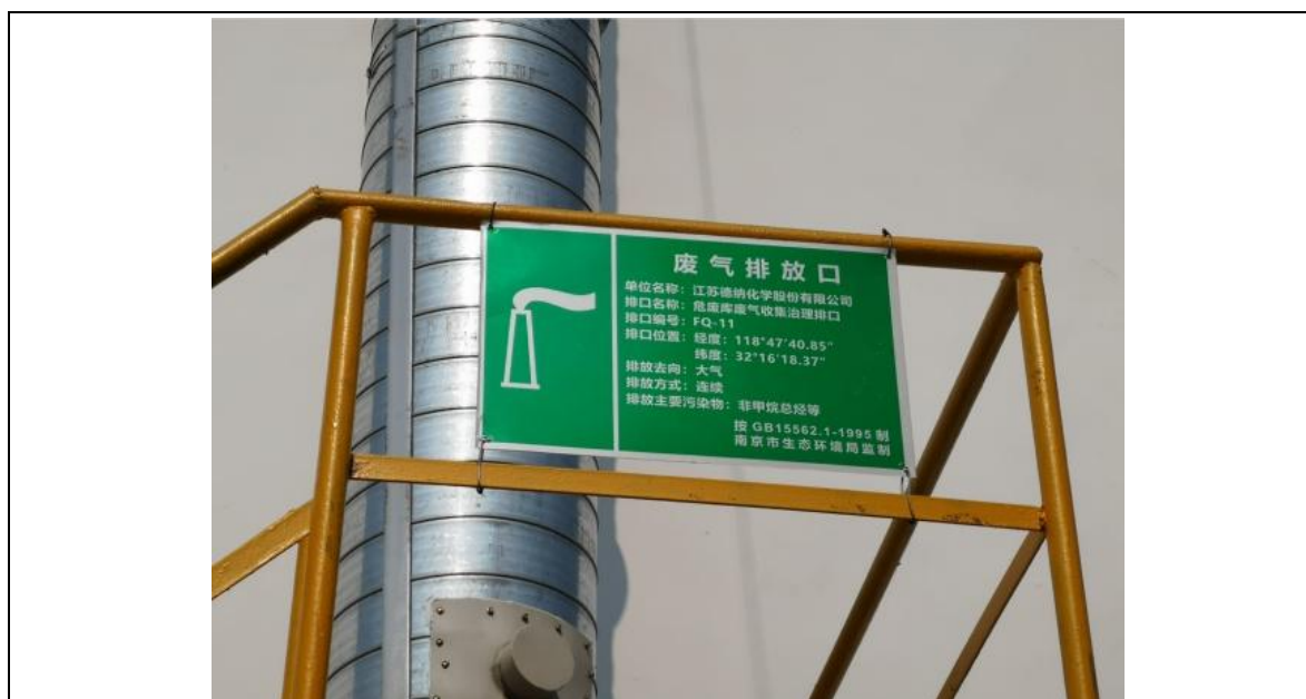
FQ-11 排口标识牌
