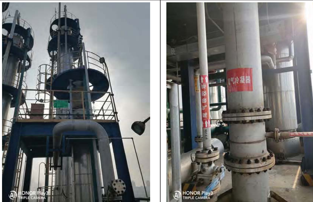
废气处理设施照片
