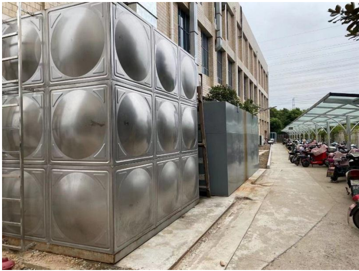
污水处理设施
