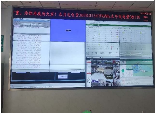
图 6.1-23 集控中心及风电场视频监控
