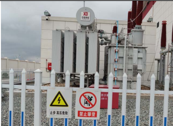
图 6.1-16 电气设备区域围挡
