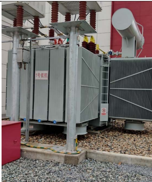
图 6.1-15 集控中心户外设备降噪措施
