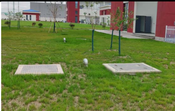
图 6.1-12 陆上集控中心事故油池
