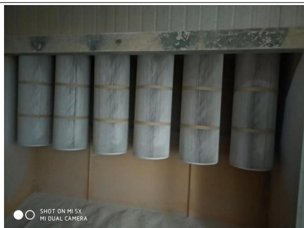
二级滤芯过滤装置
