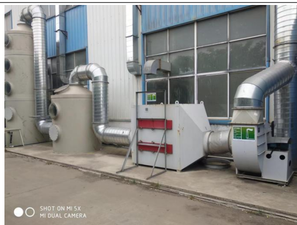
水喷淋+活性炭吸附装置
