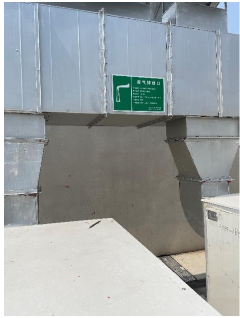
排气筒标识标牌 (FQ-3)
