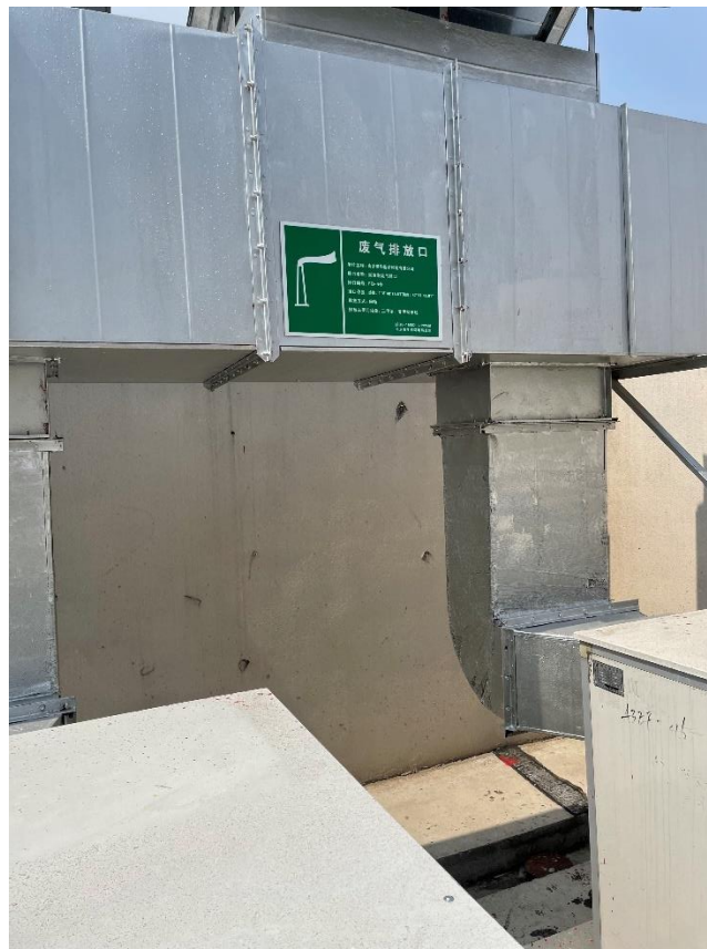
排气筒标识标牌 (FQ-4)
