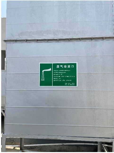
排气筒标识标牌 (FQ-2)
