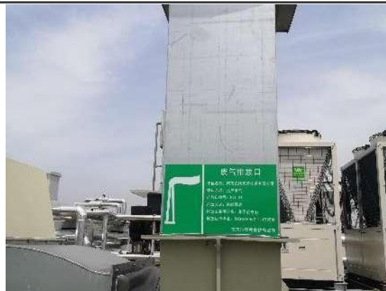
FQ1 废气排气筒标识
