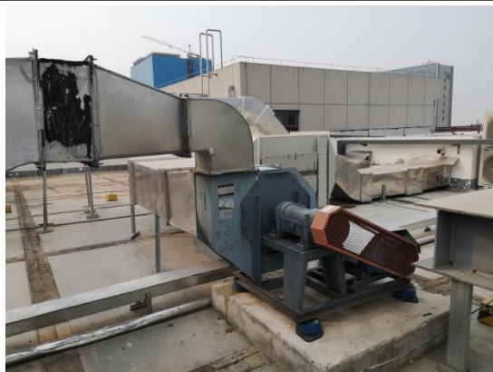
实验室废气排气筒 FQ1
