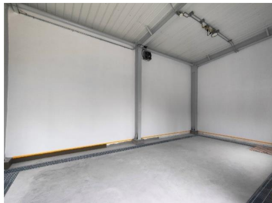
润滑油站内部
