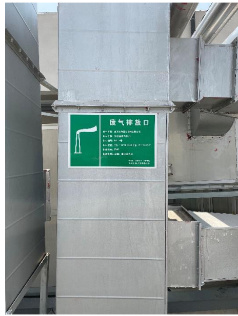
排气筒标识标牌 (FQ-2)
