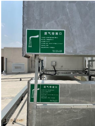
排气筒标识标牌 (FQ-3)
