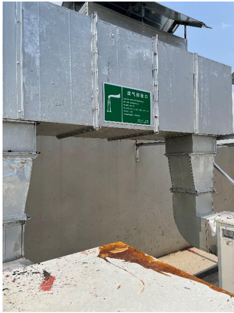
排气筒标识标牌 (FQ-1)
