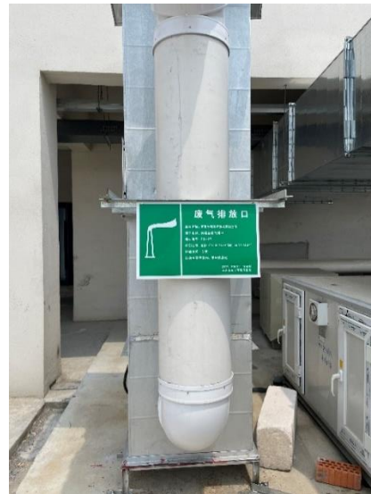
排气筒标识标牌 (FQ-4)
