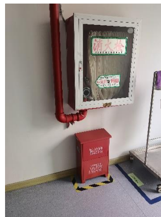
危废库旁灭火器
