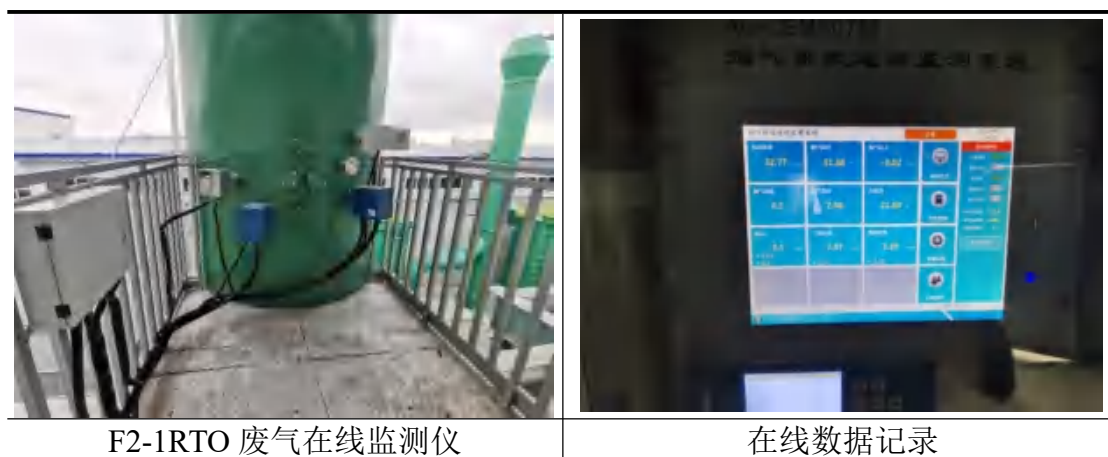
图 4.2-4 废气排放口在线监测现场照片
