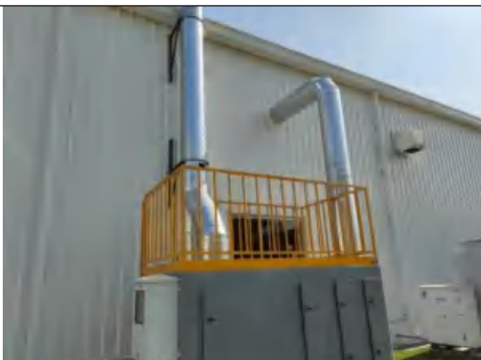
危险废物库废气处理设备
