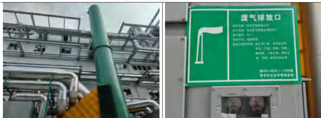
9、树脂浴缸 RTO 废气排放口 F2-1
