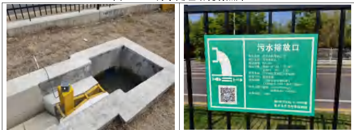
图 4.1-3 污水排放口及标识牌
