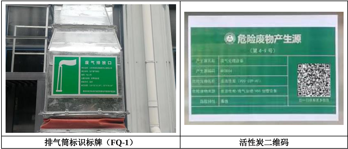
图 3-3 废气排口标识牌
