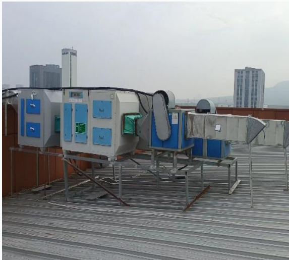
过滤棉+二级活性炭吸附装置
