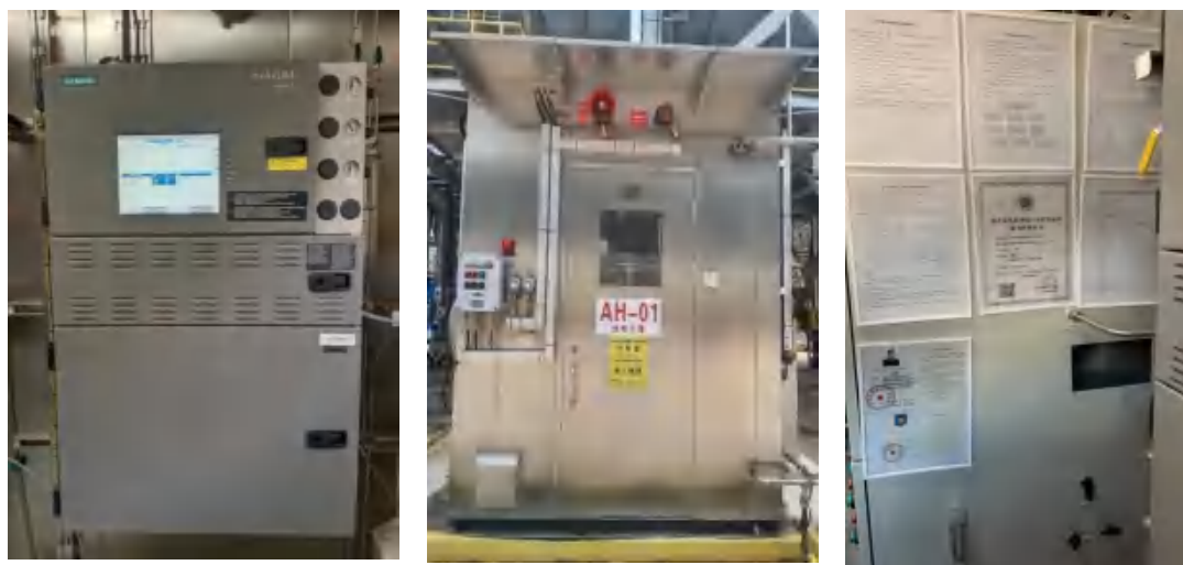
图 3-5 新建中央废气处理及能量回收单元设施在线监测设备
