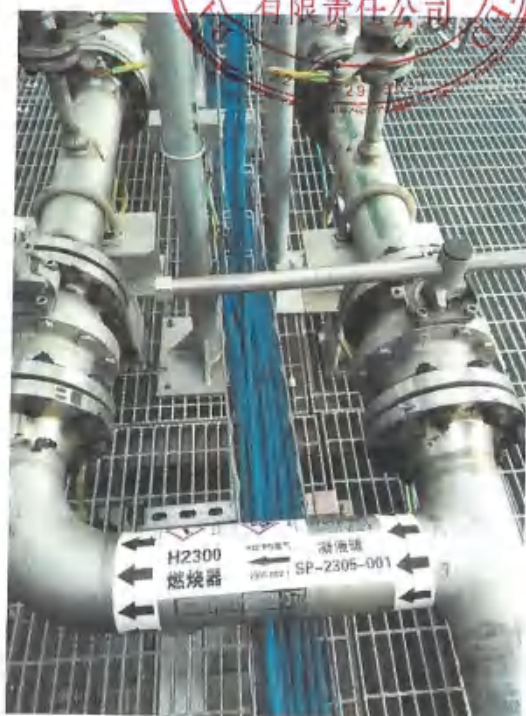
聚苯乙烯装置 PS-I 罐区废气
