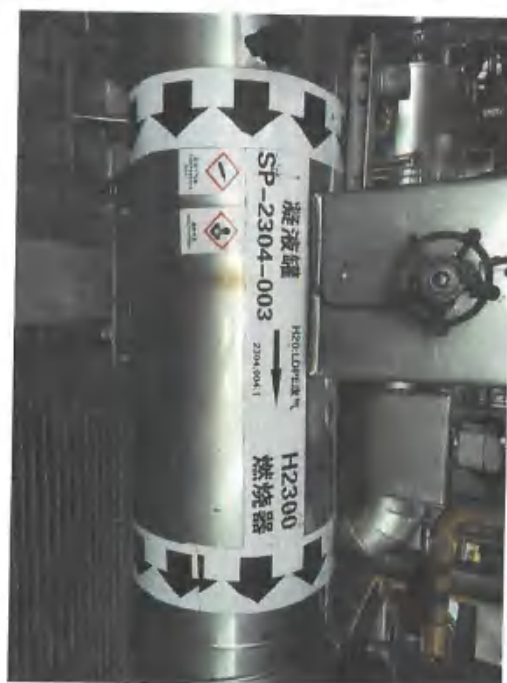
高压聚乙烯装置
