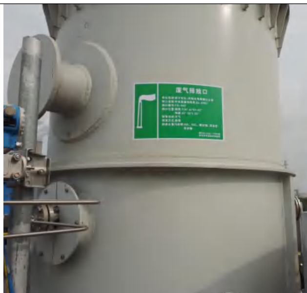
图 3-4 新建中央废气处理及能量回收单元设施废气排口（DA041）及标识
