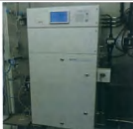
扬巴废水排放点TOC在线仪
