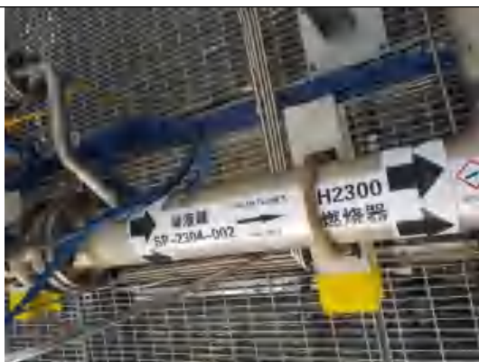
乙苯/苯乙烯装置
