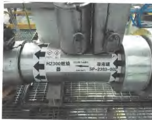
乙苯/苯乙烯装置 EB/SM-VII 污水池废气
