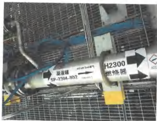
乙苯/苯乙烯装置 EB/SM-VI 苯乙烯罐区废气
