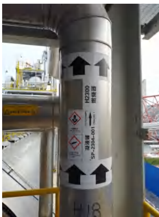
乙苯/苯乙烯装置
