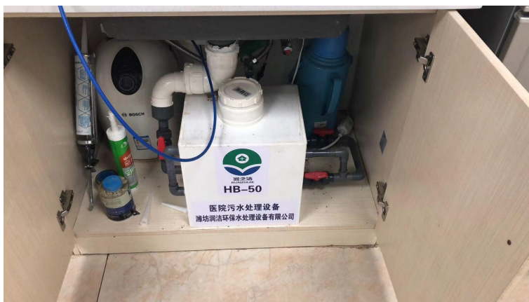
图 3-4 手术室小型医疗废水处理设施照片
