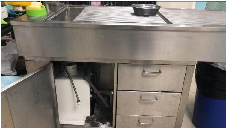
图 3-3 处置室小型医疗废水处理设施照片
