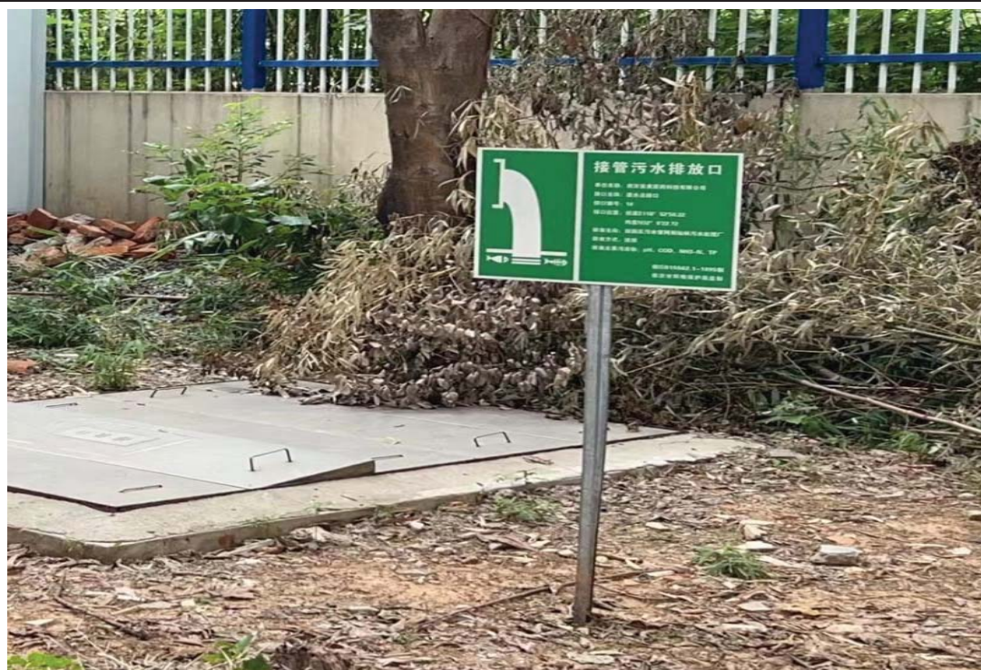
污水排口标识牌
