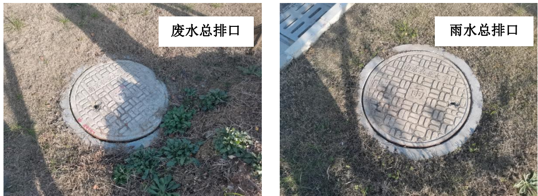
图 3-1 本项目现有废水排口、雨水排口图
