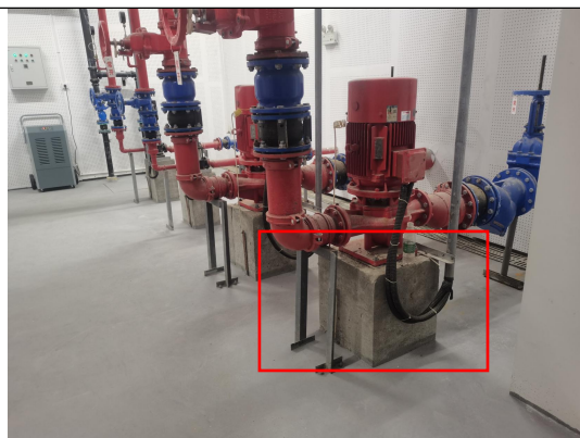
消防泵减震基础
