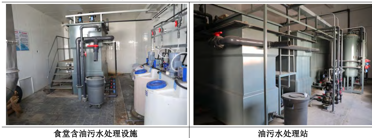
图 3.2-8 10#码头后方含油污水处理设施
