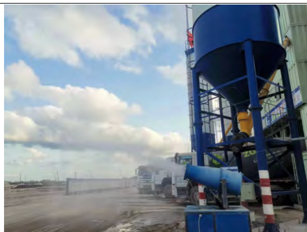
除尘装置（雾炮）
