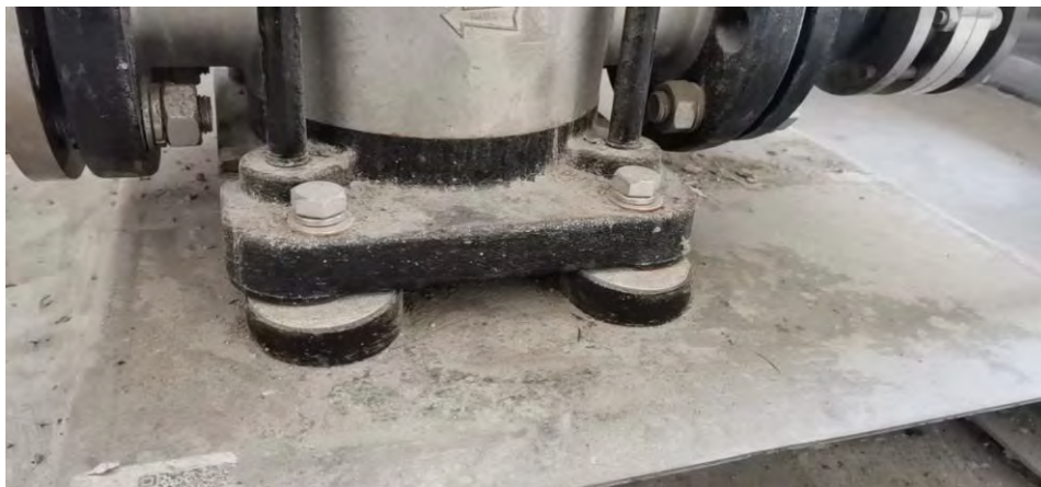
泵房设备设置橡胶垫减震措施
