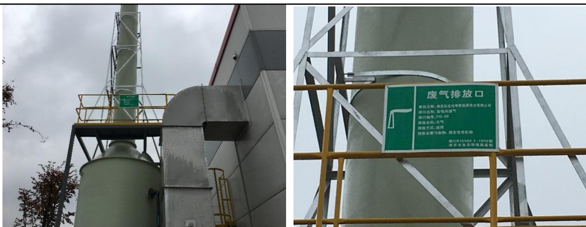
图4-6 现有项目放电间有机废气收集、处置现场图
