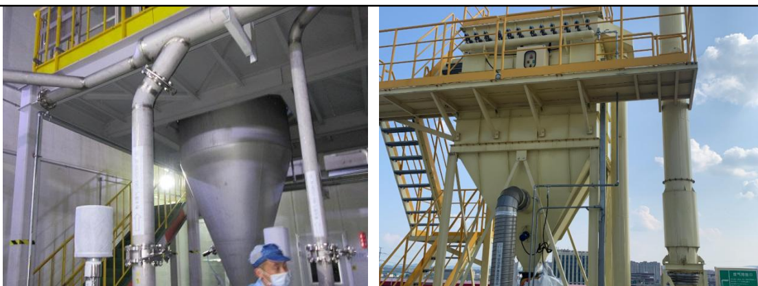
图4-3 投料工段含尘废气收集、处置现场图（管道密闭收集、布袋集尘器处置）
