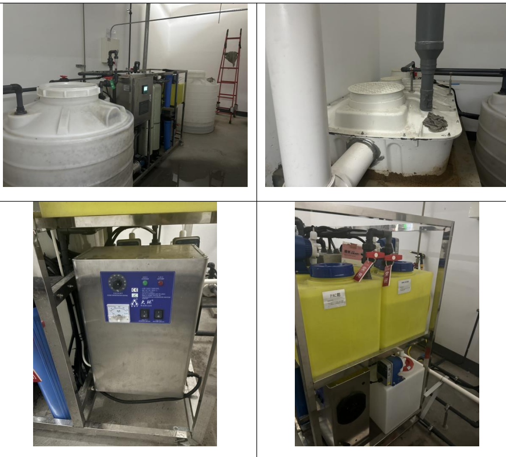
图 3-3 一体化污水处理设施现场图
