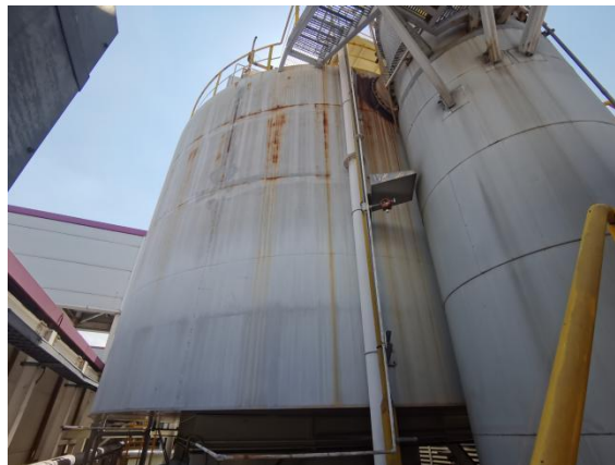
RTO 燃烧装置
