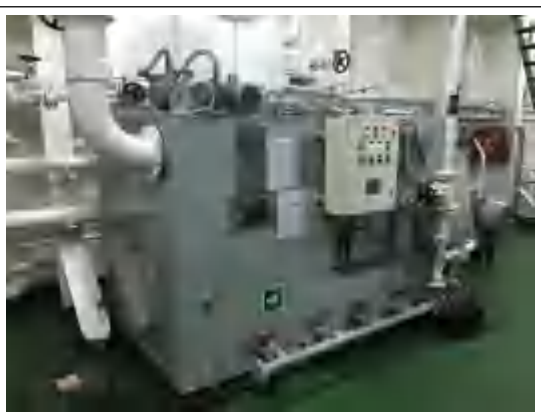
图 6.1-9 施工船舶生活污水处理装置
