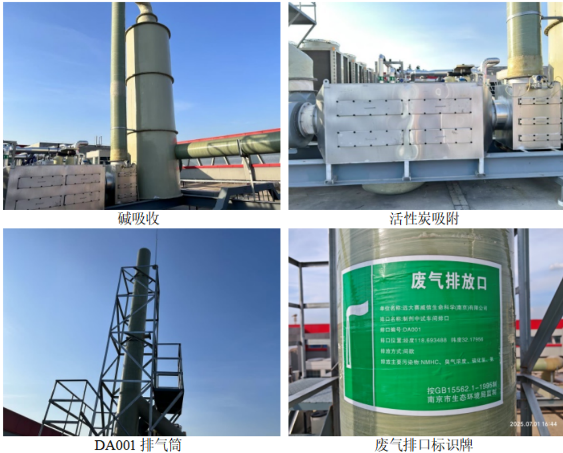
图 4.1-2 废气收集及处理设施图
