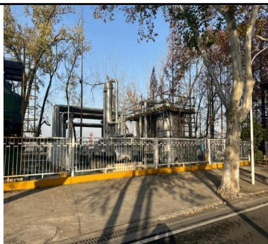
轻油装船 VOCs 废气治理装置
