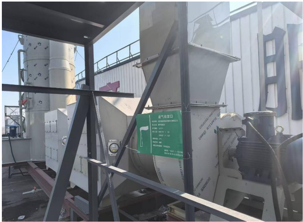
图 3-1 废气处理设施
